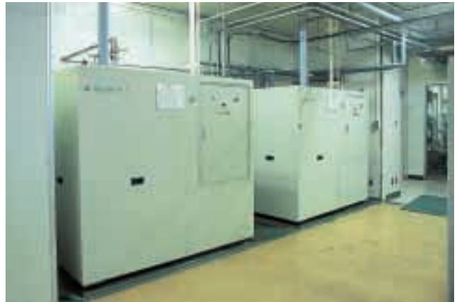
ジクロロメタン回収装置(愛鷹工場)
