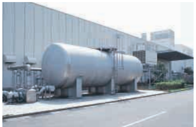
甲府工場の用水再利用設備
