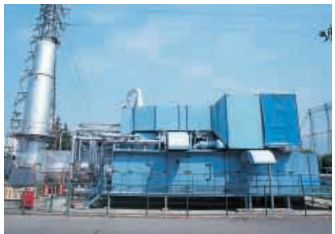
コージェネレーション設備(甲府工場)
