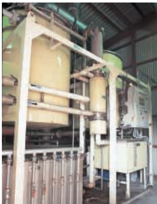
フロン回収装置(愛鷹工場)
