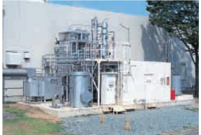
ジクロロメタン回収装置(甲府工場)
