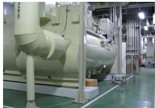
高効率ターボ冷凍機(甲府工場)
