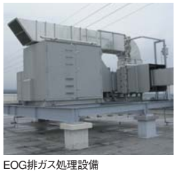
EOG排ガス処理設備
