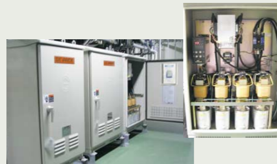
力率改善用低圧コンデンサー全景及び内部
