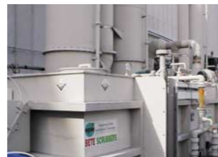
エチレンオキシド無害化処理装置
