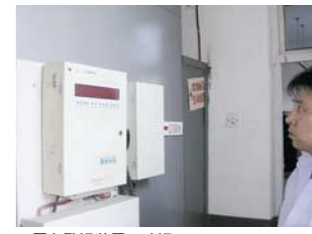
電力監視装置の確認
