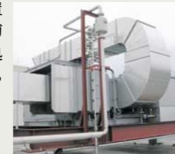
EOG排ガス処理設備
