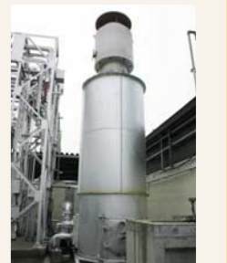
甲府工場：燃焼処理装置
