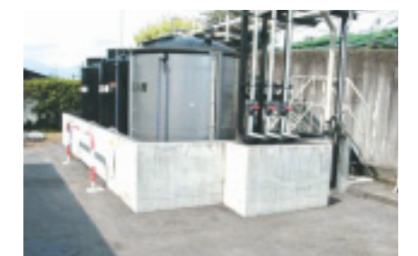
化学薬品類の漏洩対策に配慮して設置された防液堰(甲府工場)
