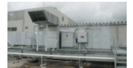
触媒フィルター方式の排ガス処理装置(富士宮工場)
