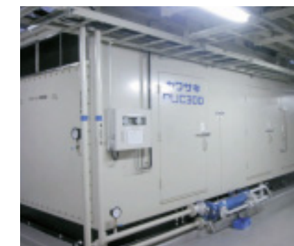
愛鷹工場ガスコージェネレーション設備
