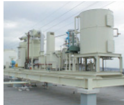
ジクロロメタン回収設備(愛鷹工場)
