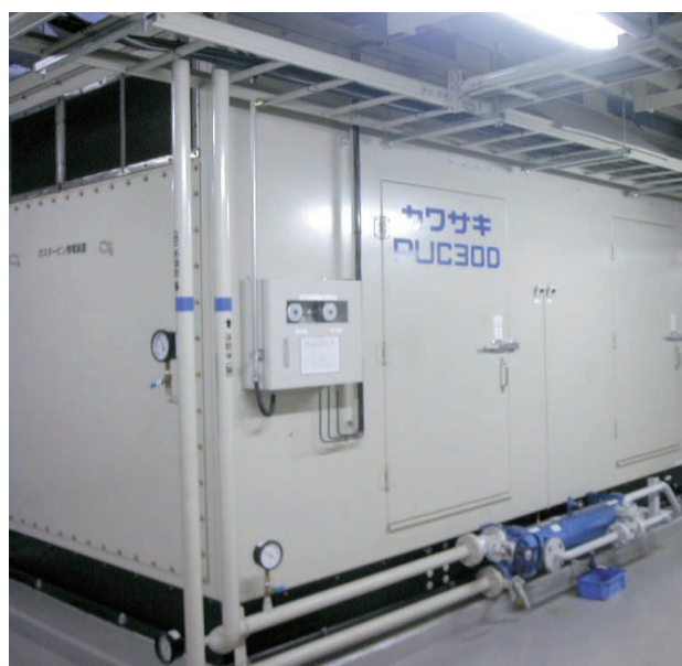
■愛鷹工場コージェネレーション設備(2000年度導入)
