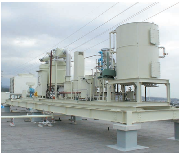
■ジクロロメタン回収設備(愛鷹工場)
