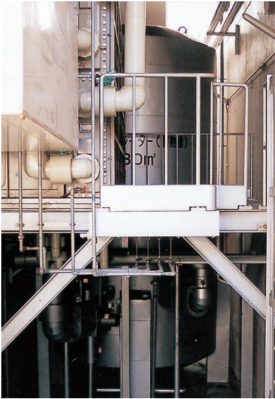
■アキュムレーター(富士宮工場)【写真中央奥】
