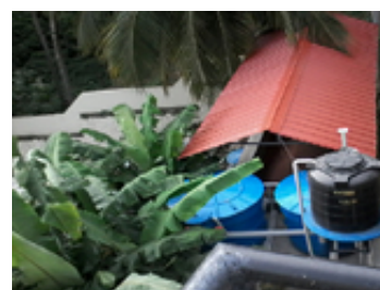
バイオガスプラント
